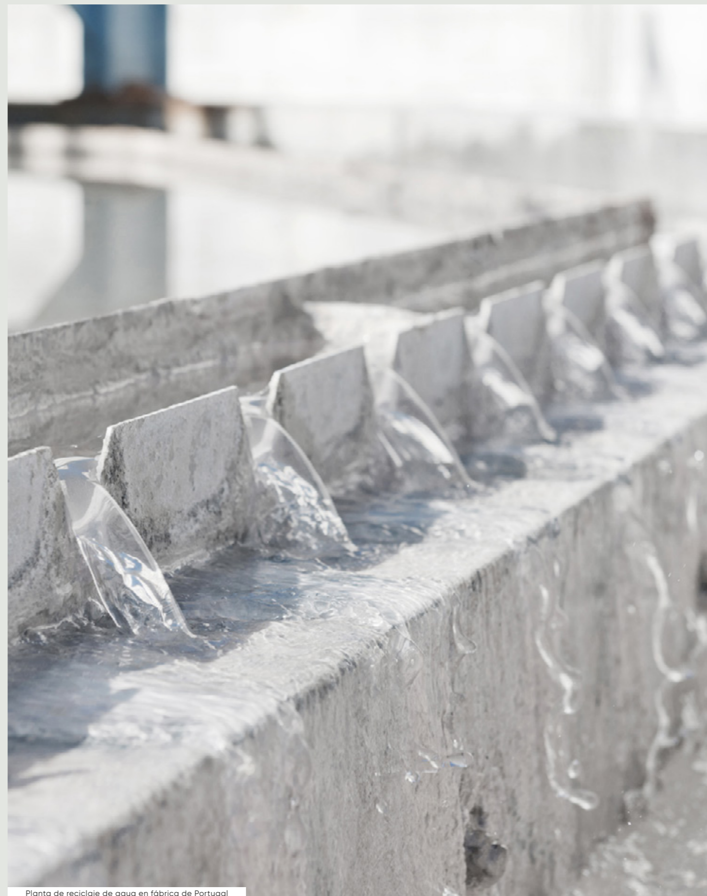
Planta de reciclaje de agua en fábrica de Portugal
