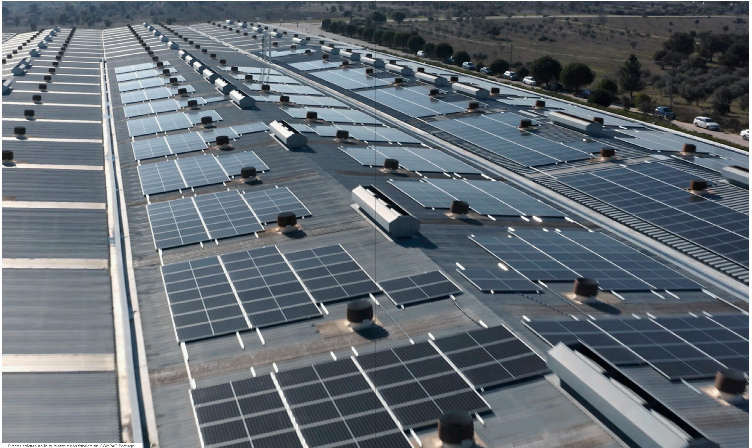
Placas solares en la cubierta de la fábrica en COMPAC Portugal
